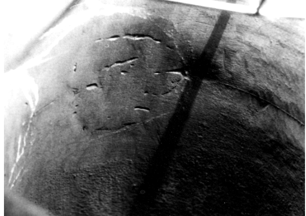
Obr.12: Pohled na opravené místo po cca 14 000 h následného provozu
